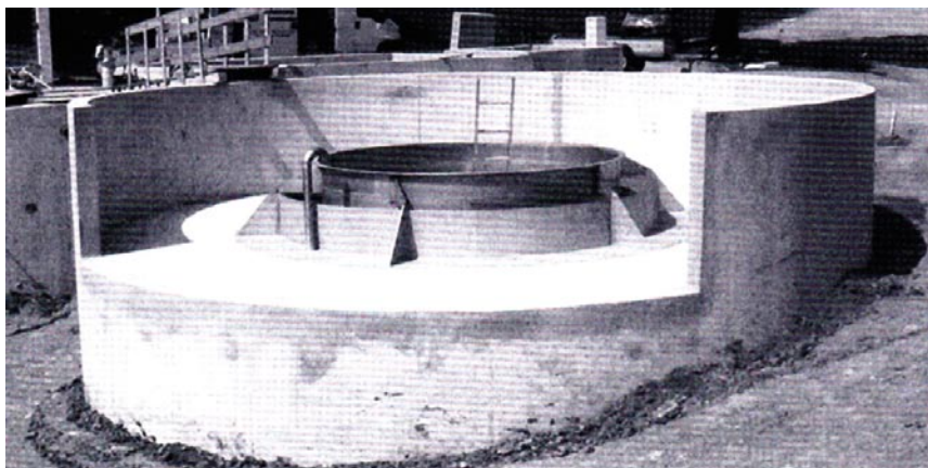
Slika 3 • Armiranobetonski vrtnični separator
