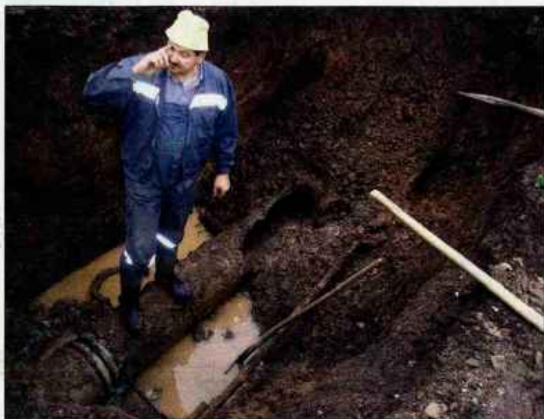
Počena cev loškega vodovoda. / Foto: Andrej Jermik
