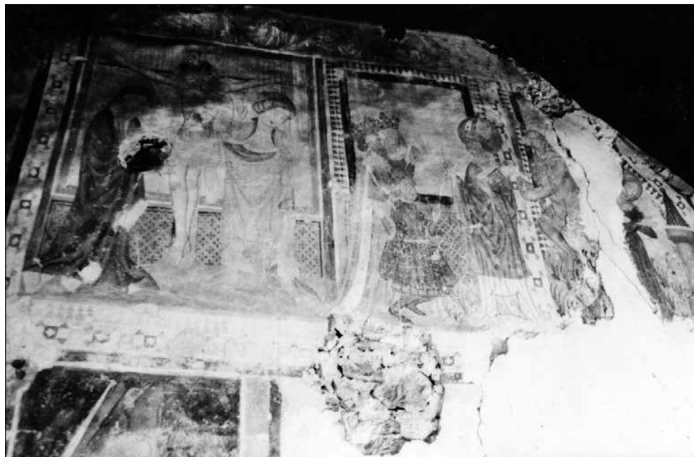
Že zelo poškodovane freske pred sanacijo leta 1998. Hrani: Zavod za varstvo kulturne dediščine Slovenije
