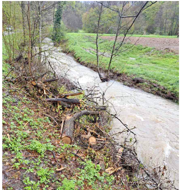
Nepospravljene brežine hudournika. Foto: Dušan Hebar
