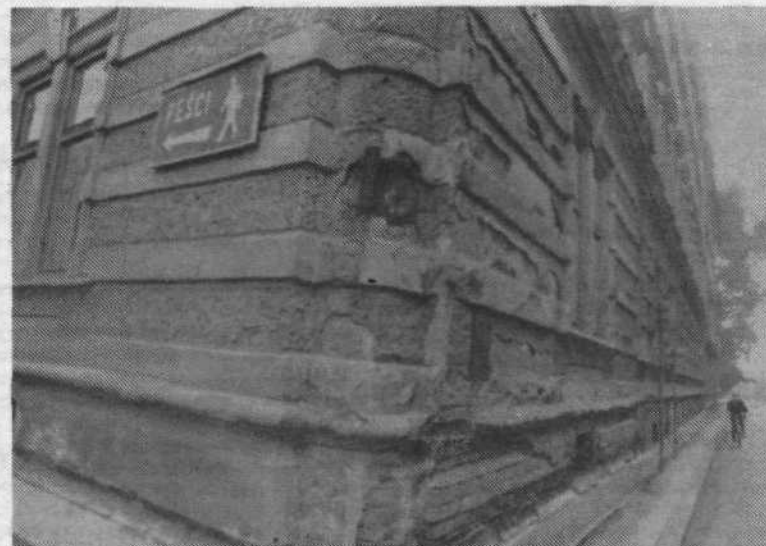
Na vogalu Rimske in Kardeljeve ulice lahko vidimo takšno podobo razpadajoče stene. Krivda je bržčas na gostem prometu, ki poteka tesno ob hišah in brzga curke vode na hišno pročelje. Kdo je v resnici odgovoren in koliko časa še? Podoba, kjer je vsak dan tudi veliko tujih obiskovalcev našega mesta, je vse prej kot prijetna.
