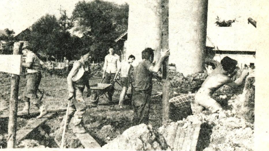
Strazišče - Križnarjevi, ki jim je prejšnji mesec zaradi strele pogorelo gospodarsko poslopje in del stanovanjske hiše, v nesreči niso ostali brez pomoči. Krajanji Strazišča so jim doslej že nekajkrat pomagali pri obnovi, da ne omenjamo tega, da so že takoj prevzeli skrb za živino. Straziški gasilci so že pred časom organizirali tridnevno akcijo, da so pomagali pri postavitvi novega ostrišja, pred kratkim pa so prav tako člani gasilskega društva pomagali pri gradnji temeljev za novo gospodarsko poslopje. - Foto: F. Perdan
