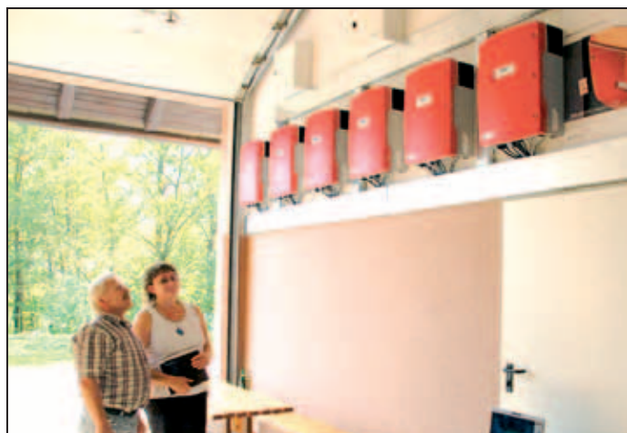
Pogled na razsmernike, ki spreminjajo enosmerni tok iz solarnih celic v izmeničnega.
