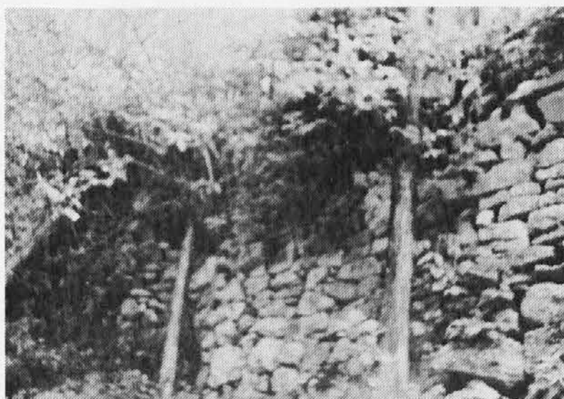
Za Gniducovo hišo stoji komaj pokonci zid. Nad njim je pot brez ograje. Prepad je globok. Treba bi bilo popraviti zid in napraviti nad njim ograjo
