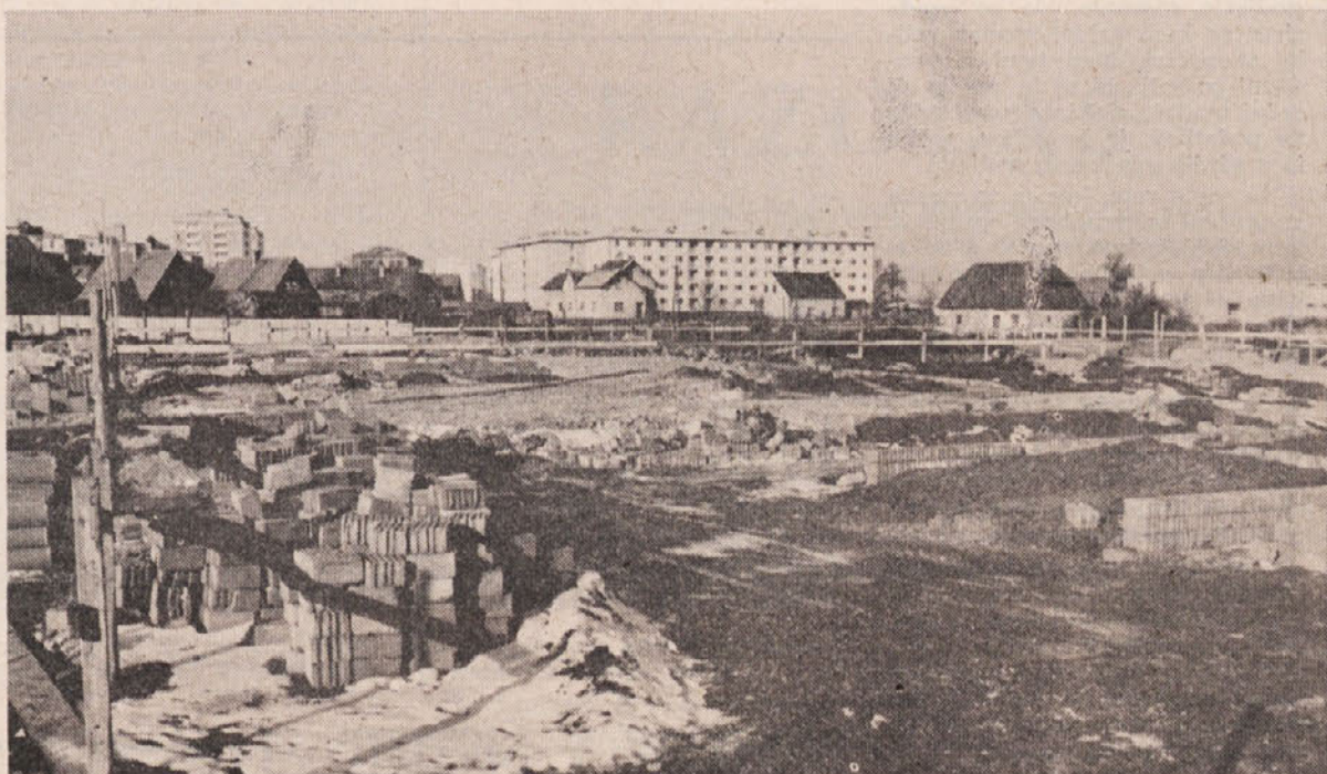
Gradbišče za »posebno šolo« ob Glaziji je že oživeło. Ceprav je rok izgradnje šele v letu 1972, čas hitro teče in si vodstvo gradbišča prizadeva čim preje zgraditi objekt do III. faze
