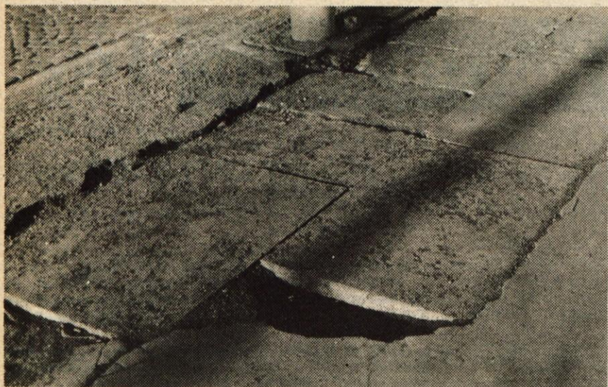
Lep čas (vsekakor predolgo) je na savskem mostu grozila tale luknja.
