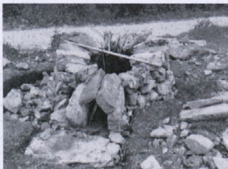
V izkopano jamo se po obodu najprej zloži debelejša kamenja, ki se na vrhu zaključijo v samonosilen obok v obliki koničaste kupole. Paziti je treba na pravilno postavitve kurišča. (Foto: Janko Rupnik)
