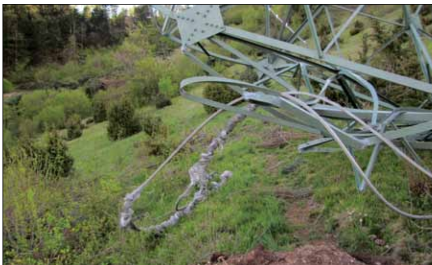
Pretrgani vodniki na stebru daljnovoda
