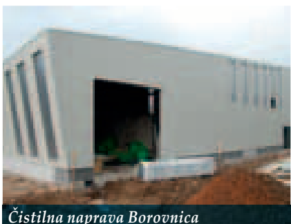
Čistilna naprava Borovnica
