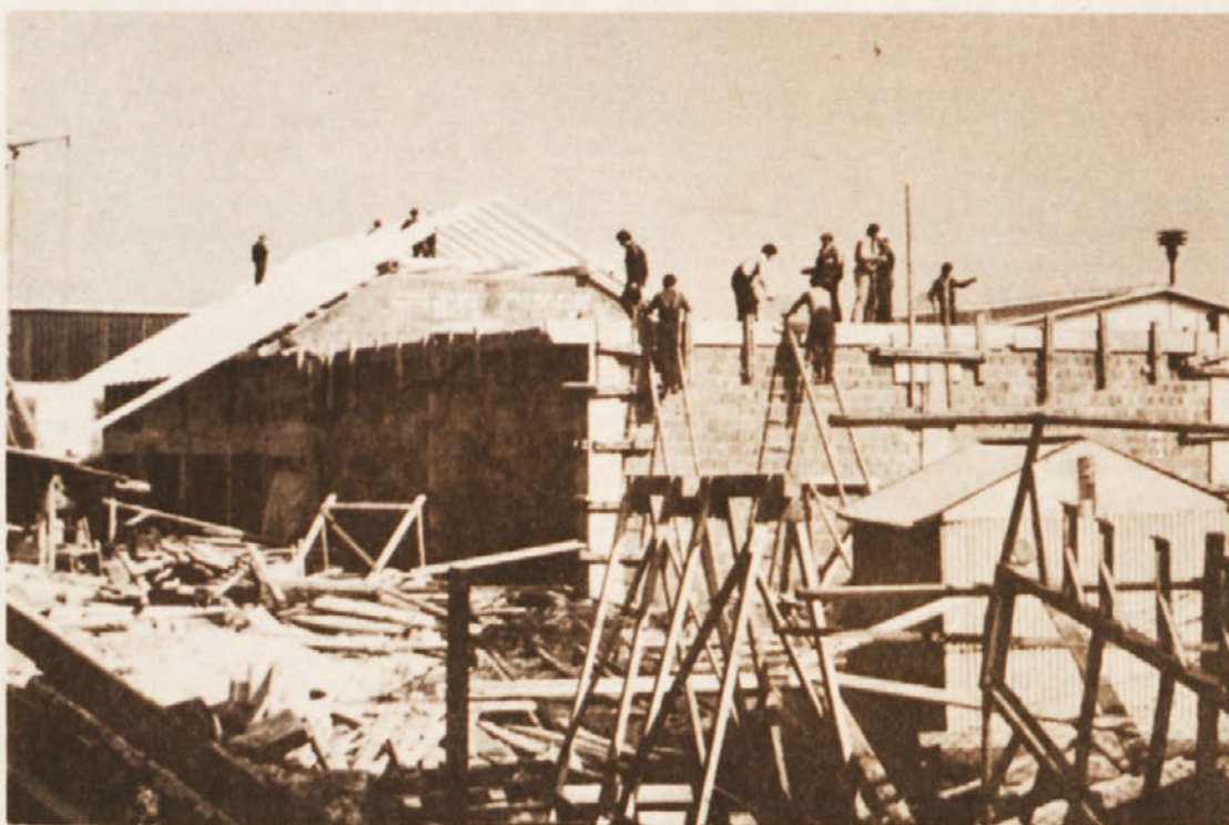
Gradnja učnih delavnic v Straži napreduje. Tudi streha bo postavljena v kratkem.
