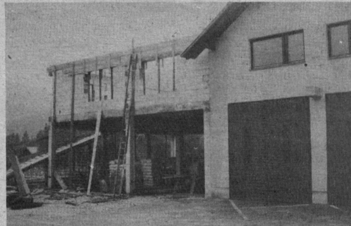
Mozirski gasilci so že na tesnem. V nadaljevanju gasilskega doma urejajo prizidek.
