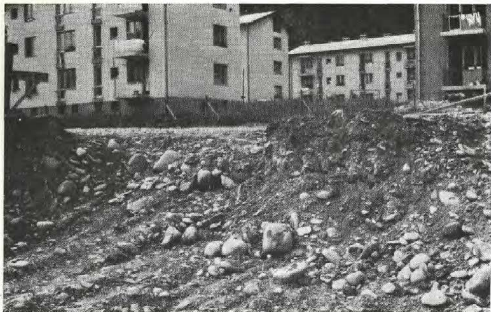
Sl. 9. Takšen prod so razkrili v vršaju Češnjice pri izkopu temeljev za številne nove stanovanjske bloke v istoimenskem naselju
