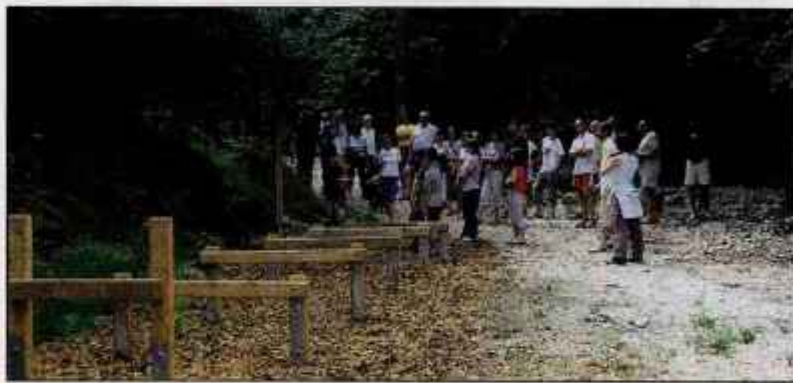
Grodja so izdelana iz lesa, vsa pa imajo betonske temelje za daljšo življenjsko dobo. /Foto: Petra Lotreč
