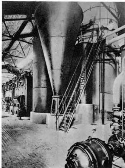
Naprava za čiščenje vode na levi v ozadju stari kotli.
