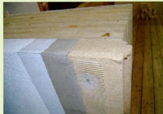
Zunanji del stene (plasti) pri gradnji s sistemom MHM: lesena hiša ohrani vse svoje lastnosti, na zunanji strani pa je lahko videti kot zidana
