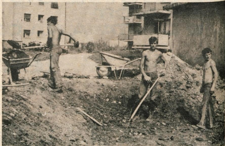
Prebivalci Plavža na Jesenicah se večkrat upravičeno razburjajo nad neurejenostjo površin med bloki, ki so bili zgrajeni med prvimi. Zdaj pa se stvari izboljšujejo, saj okolico urejajo. Delavci SGP Sava Jesenice urejajo okolico garažne hiše, ki so jo pred kratkim zgradili ob Cesti revolucije na Spodnjem Plavžu. – Foto. B. B.
