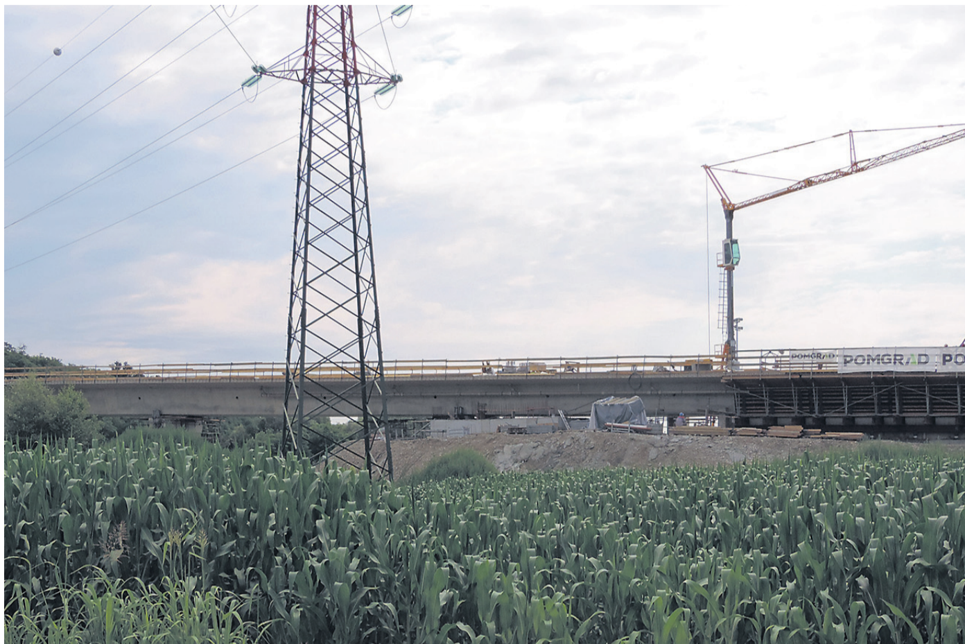
Gradnja viadukta Sejanca lepo napreduje, vprašanje pa je, kdaj se bo nadaljevala gradnja ceste proti Gorišnici in Markovcem.
