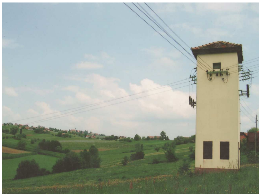
Transformator v Jastrebcih iz leta 1951
