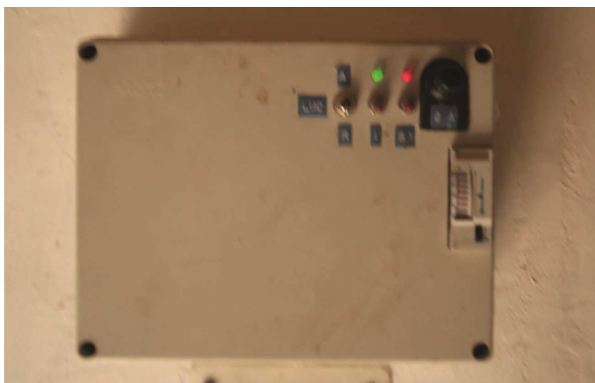
Centrala alarmne naprave za varovanje hiše, vikenda. V sestavi te so na oknih in vratih še nameščena kontaktna stikala. V slučaju , da zmanjka elektrike, prevzame funkcijo 9 V baterija v ohišju centrale.
