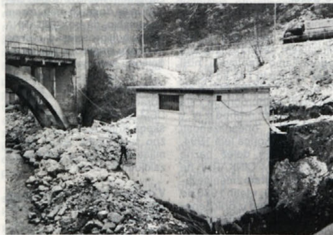
V Cinkarni izdelan HIDROZAN, vodonepropustno maso, in BETONSANIR - malto za sanacijo betona, so uporabili na eni od malih zasebnih elektrarn v Zagorju.
