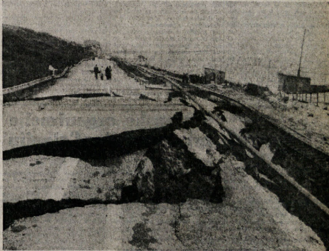
Premikanje zemlje ni rušilo le stavb ampak tudi ceste in železniške proge. Te so ponekod uničene do take mere, da jih trenutno niti ne morejo popraviti, zlasti, ker se premikanje usada še vedno ni ustavilo. Na sliki: poškodovano cestišče in železnica, ki vodita iz mesta ob jadranski obali (Telefoto AP)
