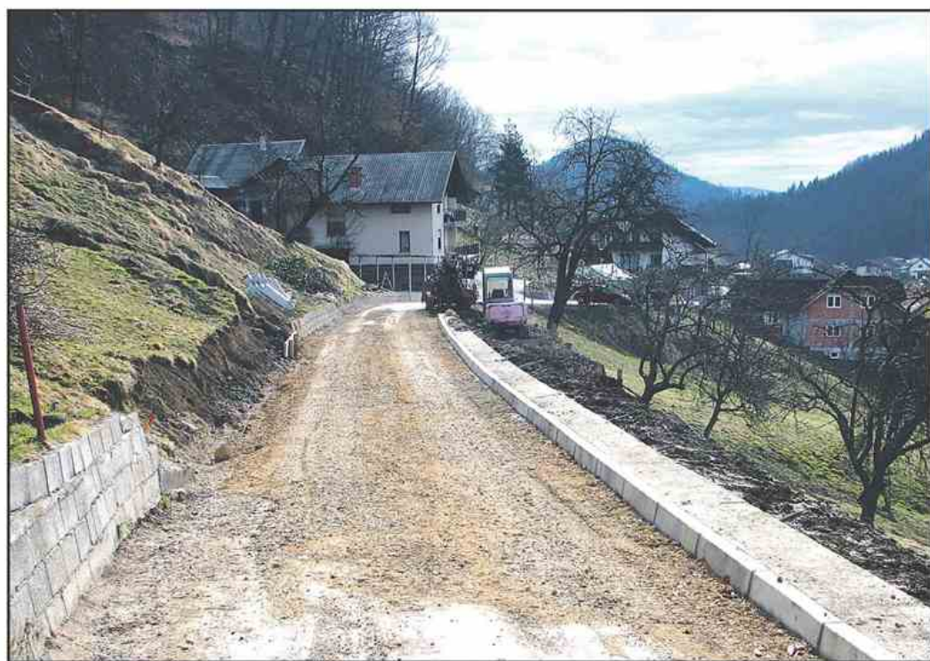
Plaz pod Jakcem drsi že nekaj let. In še vedno grozi tako cesti kot hišam pod njo. Še letos naj bi bila nevarnost odpravljena.
