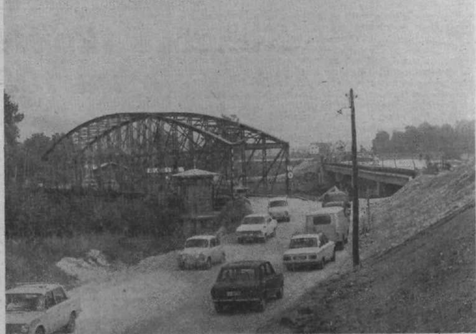
Promet po novem mostu čez Savo pri Šentjakobu bo teklen po dveh vozniških pasovih. Vozišče bo široko 8 metrov s pločnikoma ob robu, širokima po meter in pol. Železni stavec mora vzdržati do otvoritve betonskega lepoteča.
