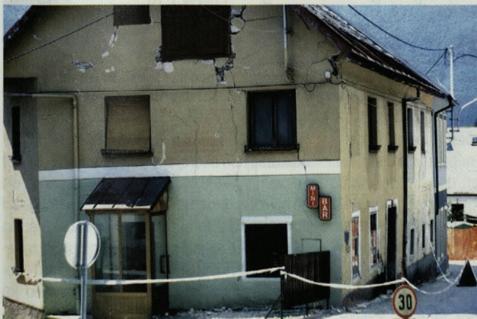
Slika 1 • Hišo, ki po potresu leta 1998 ni bila utrjena, je potres 2004 še dodatno poškodoval
