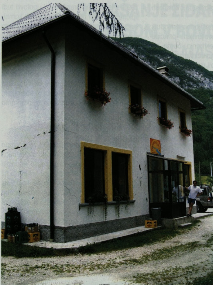
Slika 3 • Stavba D: neutrjeno kamnito zidovje v pritriljcu je bilo močno poškodovano
