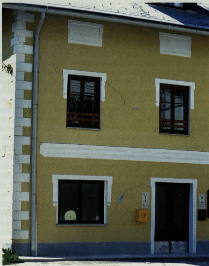
Slika 2 • Stavba A: strizne razpoke v zidovih pritličja in nadstropja
