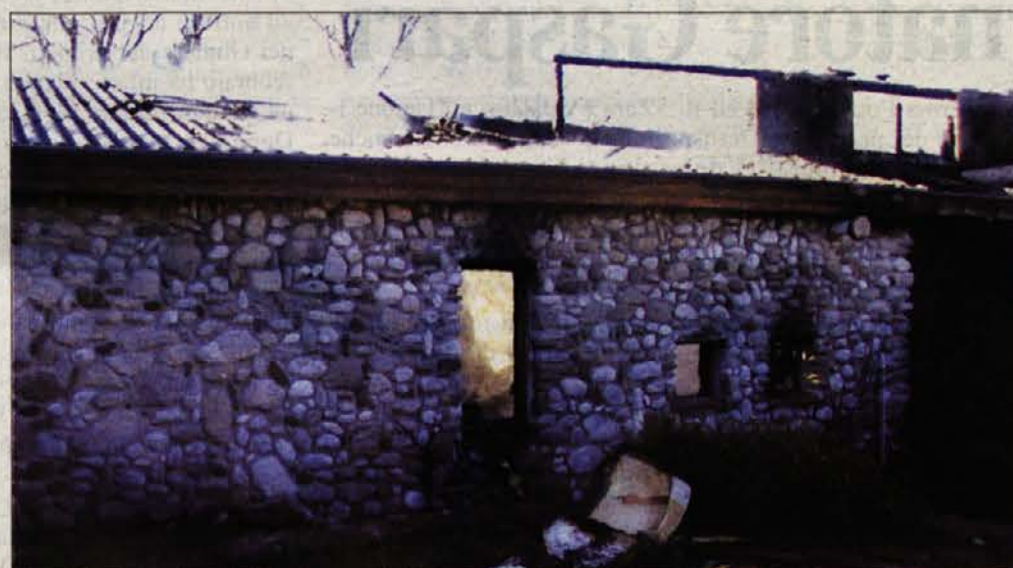
V požaru uničena Simonittijeva hiša v Spetru
