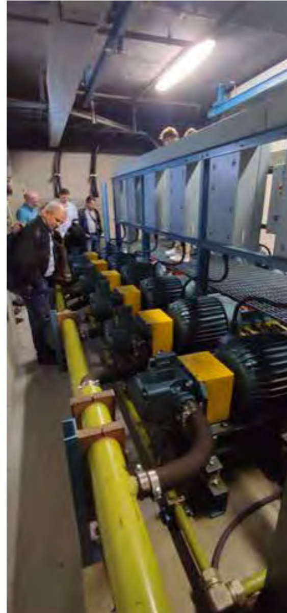
Slika 4 : Pogonski stroj z dvanajstimi črpalkami omogoča napajanje posameznih segmentov odrskega prostora
