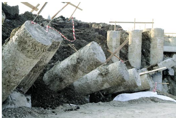
Slika 7 • Še eden od številnih primerov porušitve v gradbeni jami. Zakaj?
