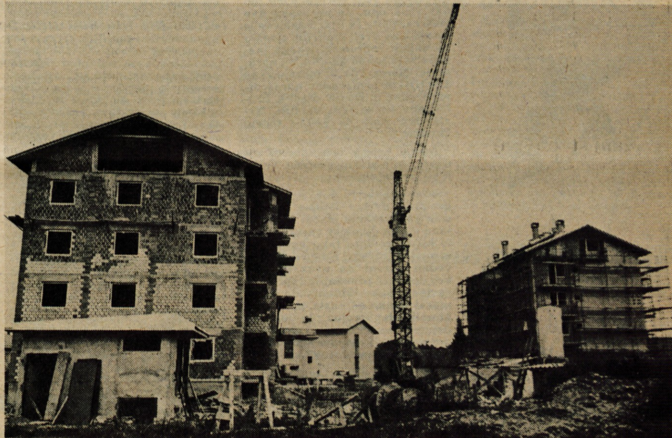
Tovarna verig, ki je že lani v Lescah zgradila dva stanovanjska bloka za svoje delavce, se je letos odločila za gradnjo še dveh blokov. V enem bo 12 stanovanj, v drugem pa 24 garsonjer. Predvideno je, da bodo stanovanja gotova do začetka prihodnjega leta. Sicer pa se bodo v Verigi, kjer imajo 1200 zaposlenih, v prihodnje najbrž lotili gradnje še dveh blokov. Čeprav imajo trenutno že okrog 200 stanovanj in vsako leto delavcem dajejo še posojila za gradnjo zasebnih stanovanj, imajo v podjetju še vedno nekaj prošenj za stanovanja. Vendar pa je število prosilcev v primerjavi z nekaj leti nazaj precej manjše. —A. Ž. — Foto: F. Perdan
