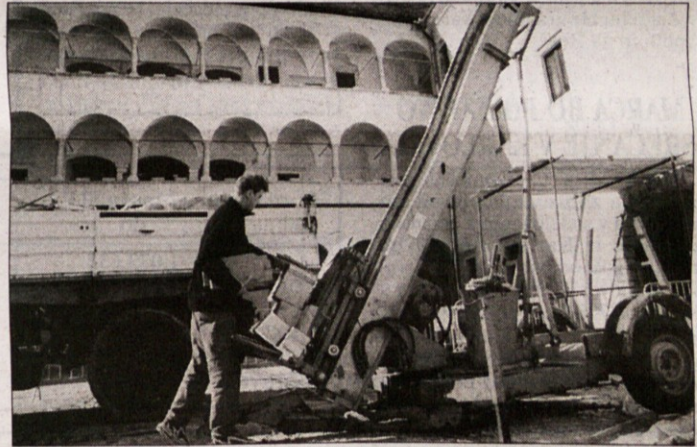
GRAD POPRAVLJAJO - Grajski hodnik v Brežicah ni tako varen pred naravnimi vplivi, kot se morda zdi na prvi pogled. Streha nekako nad njim pušča vodo in v teh dneh jo popravljajo na nekaterih najbolj dotrajenih mestih. Ob sanaciji načetega dela ostrejša se spopadajo tudi z lesno gobo, ki za brežiški grad, v katerem deluje Posavski muzej, pomeni precejšjo težavo. Vlogo, ki je ugodna za razvoj gobe, so zakrivali tudi dosedanja žlebovi, ki so bili premajhni za tolikšno streho. (Foto: M. L.)
