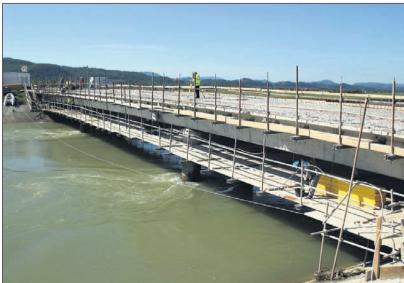
S finančnim vložkom 270.000 evrov DEM sodelujejo pri obnovi mostu čez dravski kanal med Gorišnico in Gajevci. Obnova naj bi bila končana do 15. julija letos.
