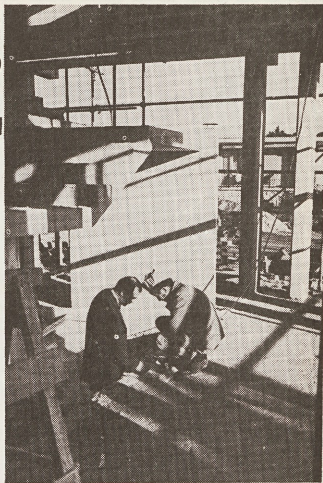
Igra sonca in senc na gradbišču . . . Kako bo v prihodnje s terenskimi dodatki?
