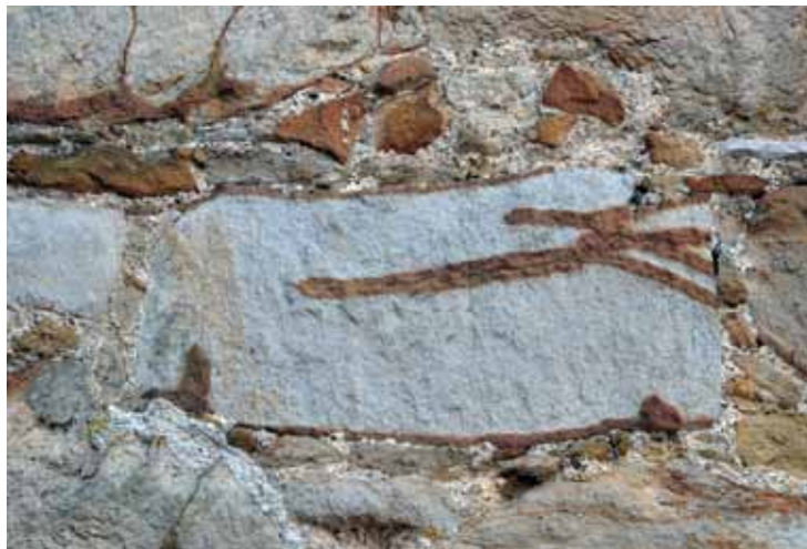
Slika 20: Če voda najde pot po razpokah, peščenjak prepereva samo vzdolž njih in po površini. Tudi ta primer je z obzidja Ljubljanskega gradu. Foto: Matevž Novak.
