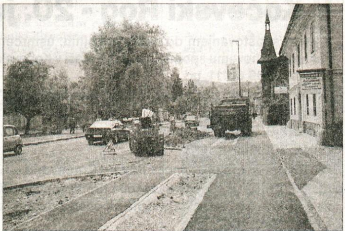
Prav sedaj dokončujejo rekonstrukcijo Tržaške ceste, ki bo dobila pomen mestne ulice, z možnostjo parkiranja na obeh straneh, kolesarsko stezo ter obnovljen pločnik.
