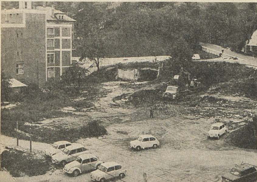
Po dolgih letih razprav, priprav, čakanja, itd., je končno 30. 8. 1977 bager prvič zasadil »lopato« na bivšem Volajavem zemljišču poleg splošne bolnišnice v Trbovljah. Inženiring nad gradnjo ima RUDIS, gradbena dela pa izvaja GIP BETON Zasavje — TOZD Operativa Zasavje, Trbovlje. Upamo, da bo objekt dograjen v dogovorjenem roku. (Foto M. C.)
