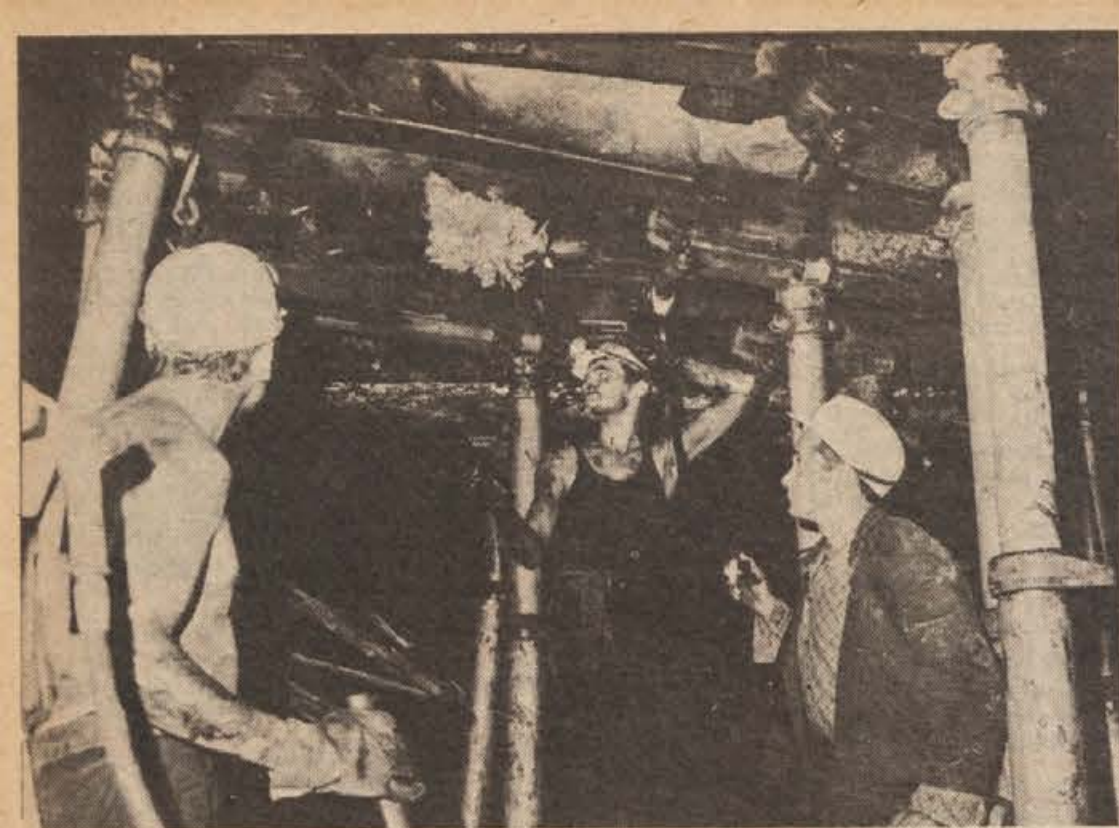
Teškočina v hidravličnih napravah pomika stropnike in podpornike v zeleno smer. Podpiranje jame je sedaj enostavnejše in varnejše. (Foto: M. Vesel)
