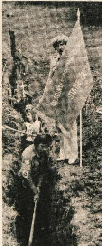
Do nedelje bodo brigadirji izkopali nekaj sto metrov dolg jarek za vodovod
