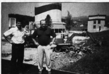
Pripravljalna gradbena dela 1998. so se začela s pripravo platoja za glavni pogonski objekt (GPO).
