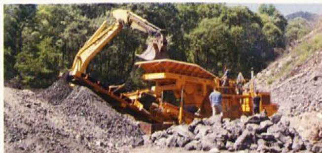
Stroj za drobljenje gradbenih materialov na Haldi. Zaposleni pri drobilcu povedo, da je žlindra veliko trdnjša od betonskih ruševin.
