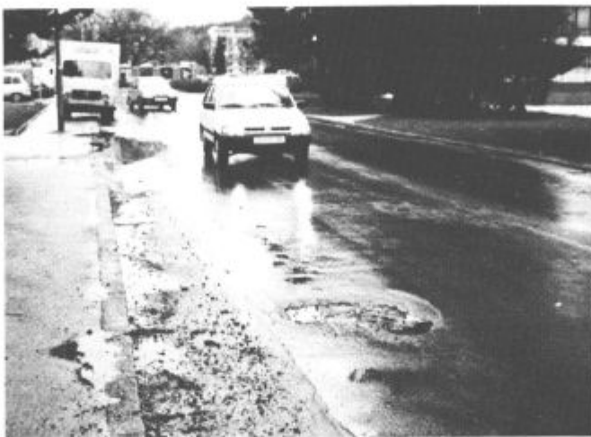
Rudarska cesta je nujna obnove, preden si na njej kdo ne zlomi noge, all se zgodi še kaj hujšega
