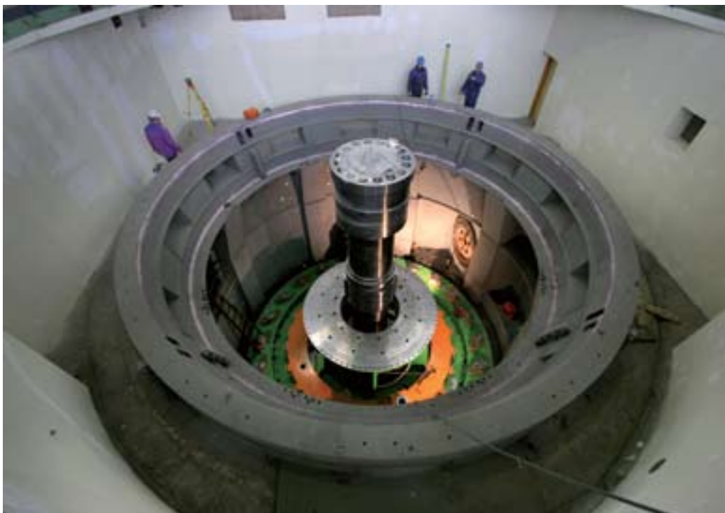
Pogled na turbinski jašek, v katerem je nameščeno osjo turbine.
