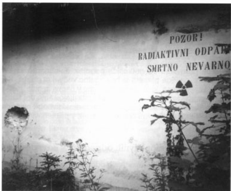
Slika 4a: Opozorilni napisi na kaverni
