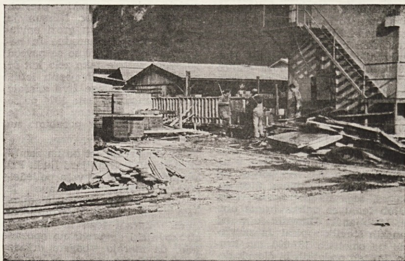
Na takem gradbišču ni varno delo
