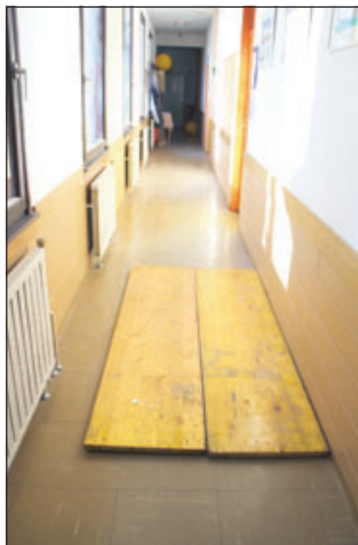
V enoti Vrtca Dragomer je decembra počila vodovodna cev, ki so jo že sanirali.
