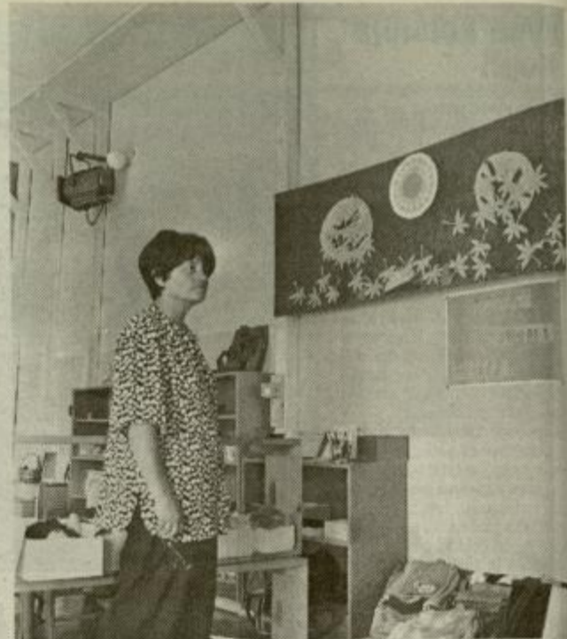
Vodja šole v Socki Erika Ravnak pod podprtim stropom, ki je lani padel na tla.
