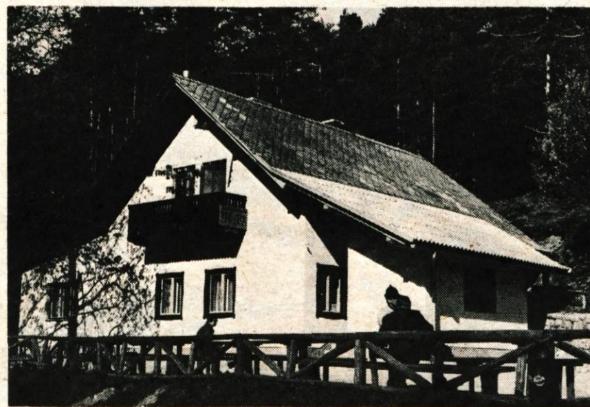
Lani je v gostišče v Dragi, last turističnega društva Begunje, treščila velika skala in staubo močno poškodovala. Potem so jo delno preuredili, vendar je ostalo še precej nedokončanova. Da bi opravili vse potrebno, turistično društvo Begunje potrebuje okrog 60.000 dinarjev. Na zadnji seji upravnega odbora Gorenjske turistične zveze so sklenili, da bodo predstavniki zveze skupaj z vodstvom turističnega društva Begunje skušali najti posojilo za uresničitev predvidenega programa. — A. Ž. — Foto: F. Perdan
