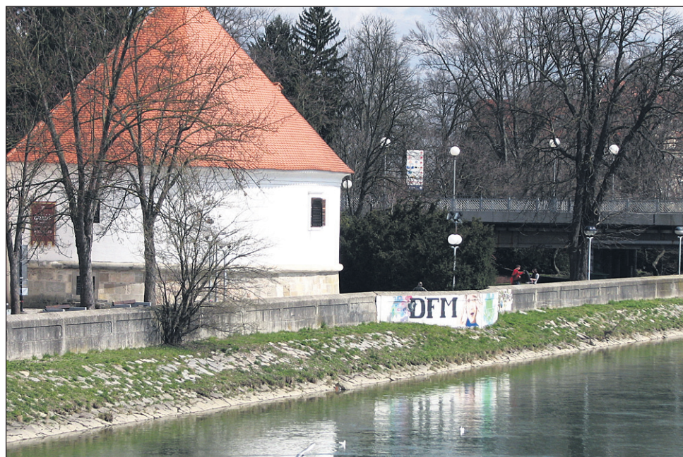
Razpoka na betonskem zidu ob Miheličevi galeriji na Ptuj po besedah tehničnega direktorja DEM Andreja Tumpeja ni nevarna, zato (prednostna) sanacija ni nujna.
