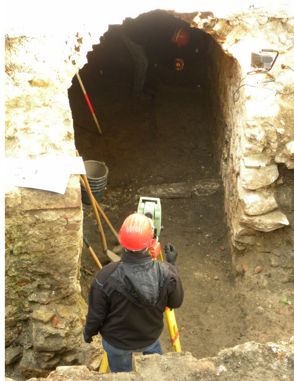
Slika 80 Stratigrafsko izkopavanje in dokumentiranje nasutij znotraj kletnih prostorov pod vzhodnim traktom; pogled proti jugozahodu (foto E. Lazar).
